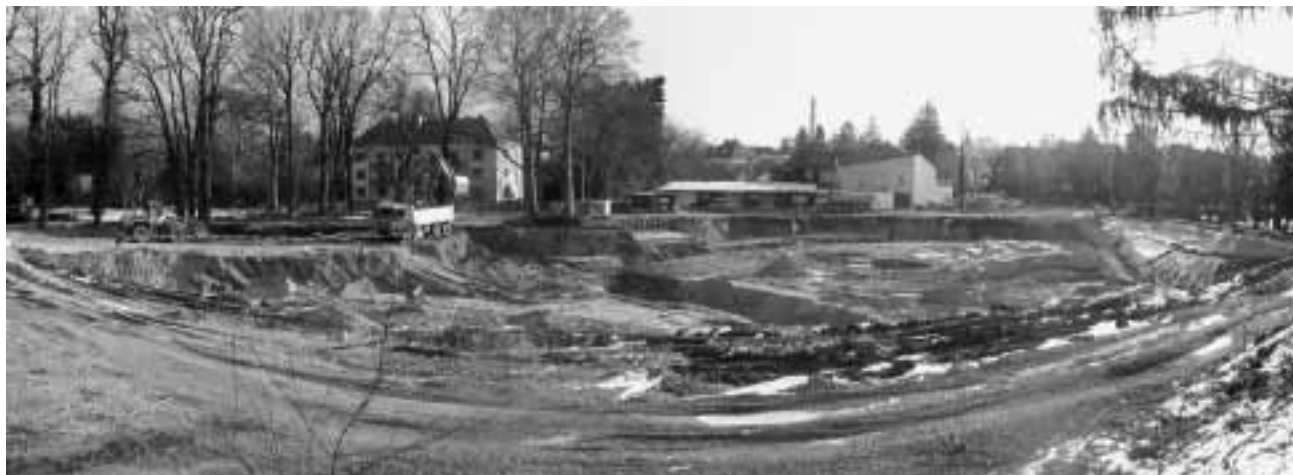
Die Baustelle des Kurzentrums, gesehen von der Jägermayerstraße in Richtung Badnerstraße. Hier entsteht ein moderner Kurbetrieb mit 400 Betten.
